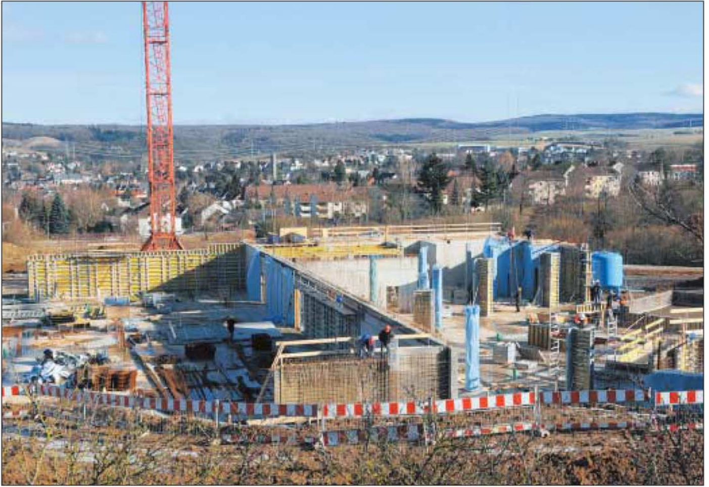
Der strenge Winter hat die Bauarbeiten im Idsteiner Nassau-Viertel für Wochen zum Erliegen gebracht. Jetzt drehen sich auf der Baustelle des Tournesolbades wieder die Kräne. Foto: wita / Udo Mallmann
